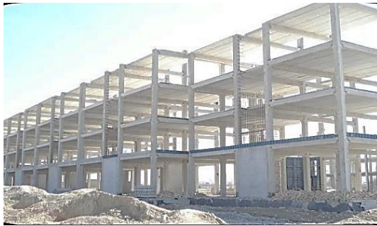
شکل ۱-۲۷ قاب ساختمانی ساده بتن‌آرمه پیش‌ساخته و دیوار برشی بتنی درجا و سقف‌های پیش‌ساخته
